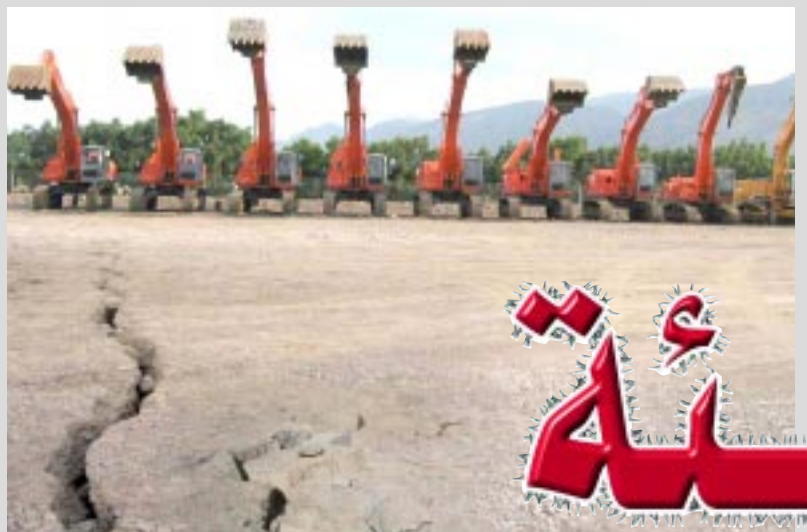
تشققات في الطريق أثناء الرصف نتيجة غياب الدراسة الجيولوجية..
