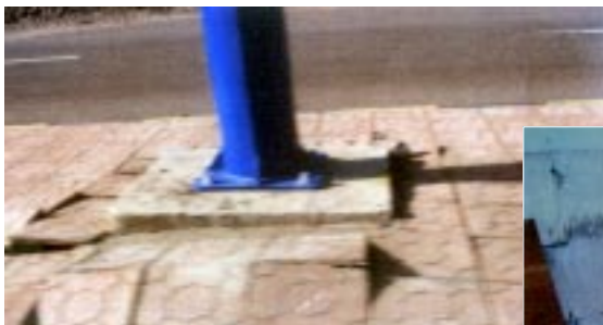
□ صورة توضح سوء تنفيذ الأعمال في الأرضية
